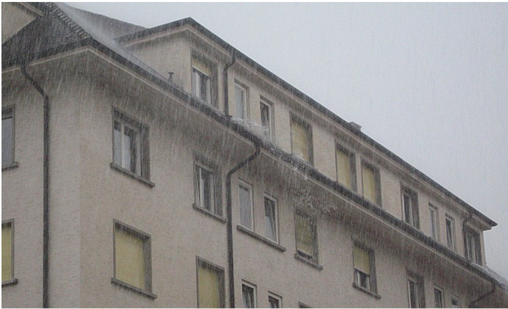
Überlaufendes Dachentwässerungssystem während des Starkniederschlags vom 26.6.2009 in Fribourg (© Christine Bläuer)
